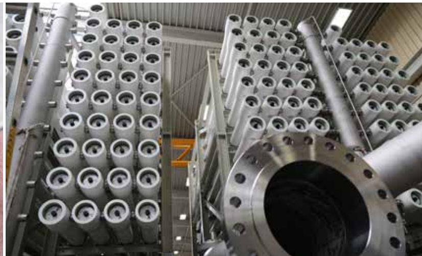
Ein- und Aufbaufertige Racks
